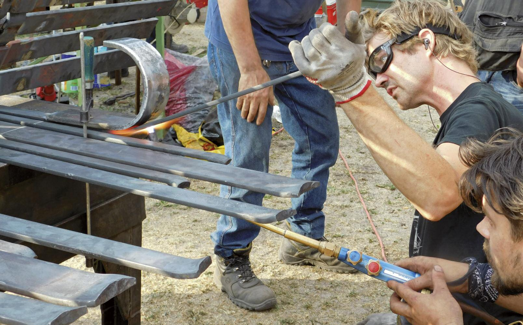
Beispielhaft für eine gute Planung und Vorbereitung: Georg Reinking hatte sich für die Biegungen der Lehne und der Beine der Bank schon zu Hause eine Biegelehre vorbereitet. Mit dem Brenner wurde nach und nach die Rundung passgenau vollzogen
